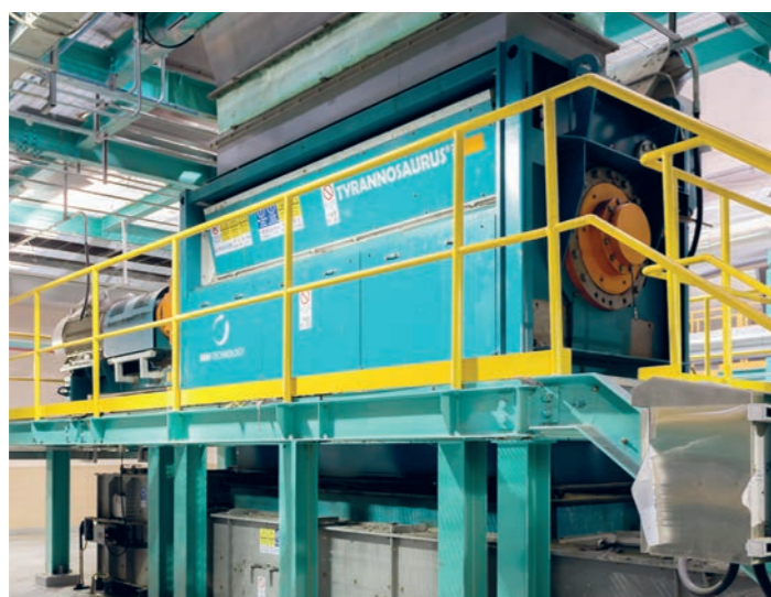
Las grandes puertas y trampillas permiten acceder al triturador con facilidad.
